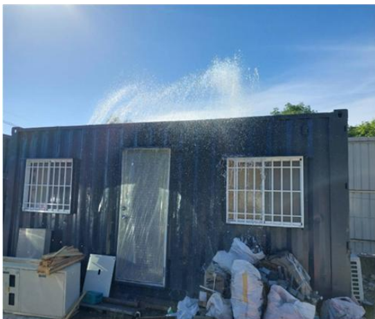
工務所屋頂的自動灑水設備
